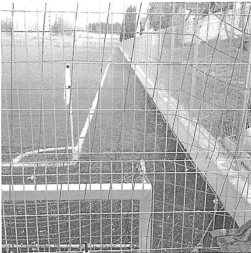
Veszélyes betonlábazat, fedkövel, tárolt kapukkal
