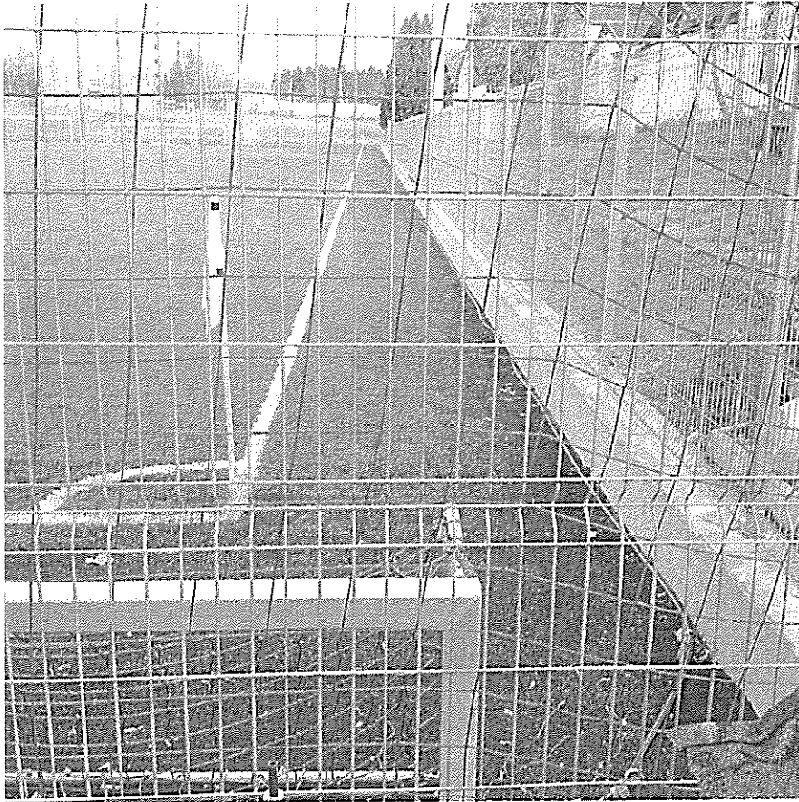
Veszélyes betonlábazat, fedkövel, tárolt kapukkal
