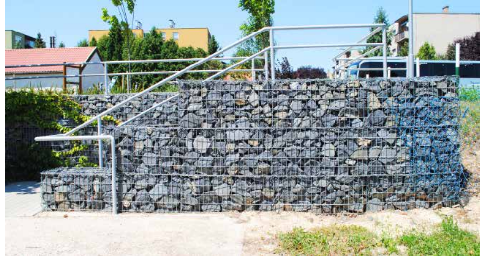
Gabion támfal és tereplépcső igényes megoldás nagyobb szintkülönbség áthidalására
